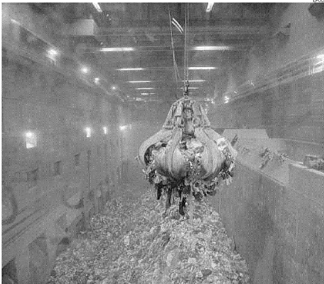
► L'interno di un termovalorizzatore: Penati vorrebbe aprirne uno nuovo in provincia
